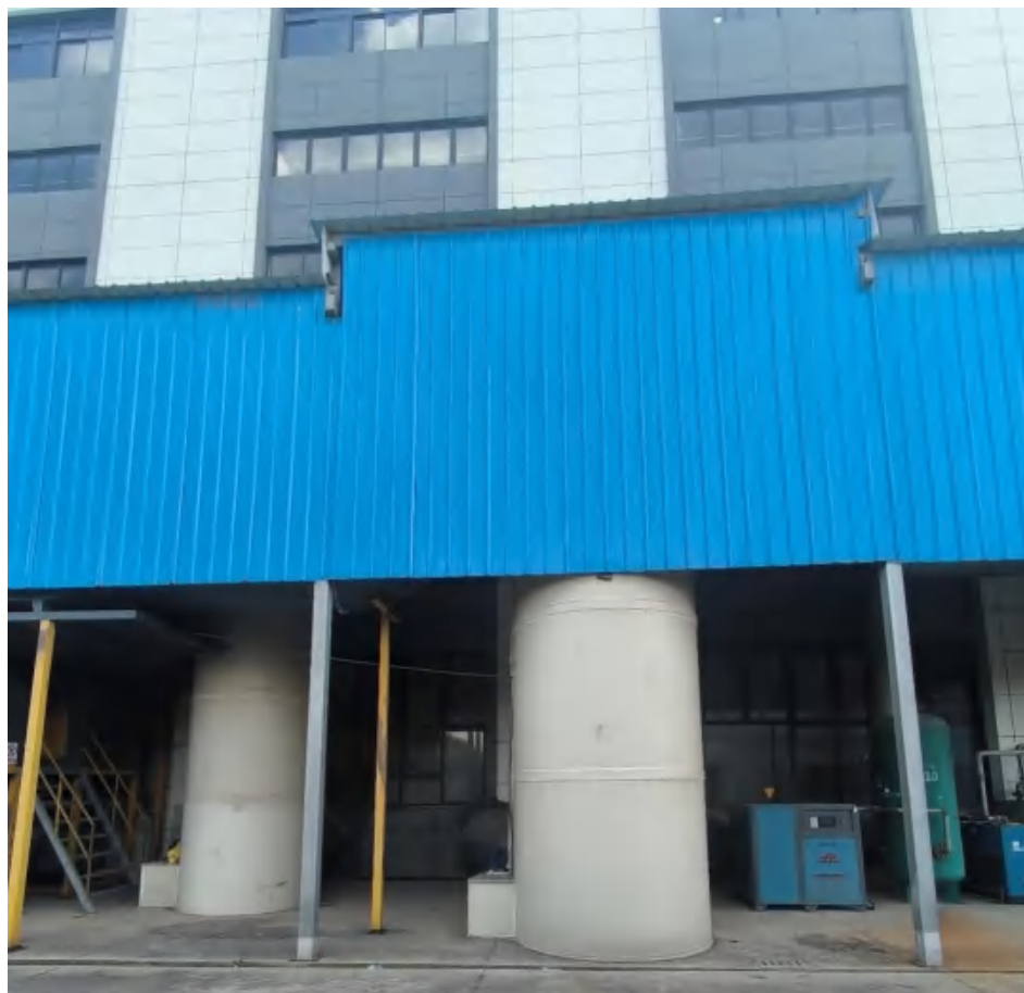
图4-3 水喷淋塔照片
