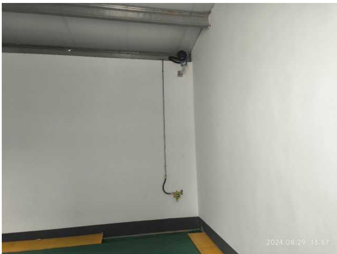
图4-13 危废仓库内摄像头及导流槽照片
