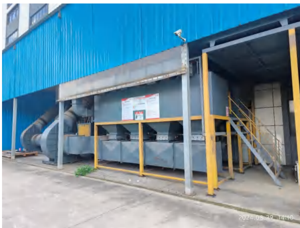
图4-4 干式过滤+活性炭吸附脱附+催化燃烧照片
