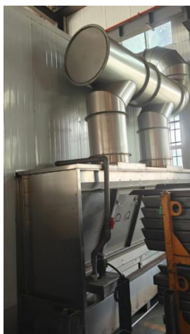
废气处理设施（水帘柜）
